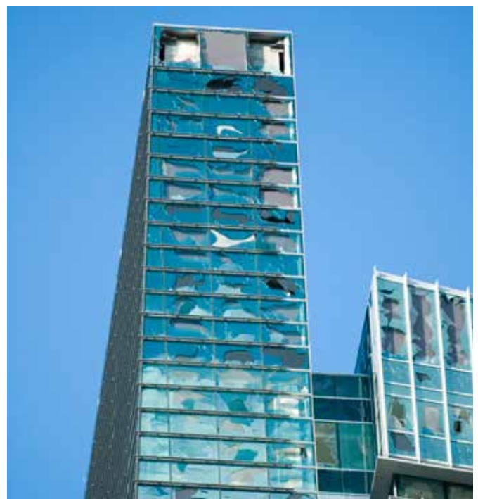
La elevada velocidad del viento durante un huracán puede destruir un edificio en horas. Daños en el edificio de un banco en Brickell Avenue por el huracán Wilma
